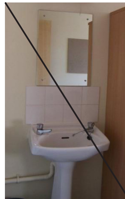
Плохо Раковина с пьедесталом. Фартук из плитки
